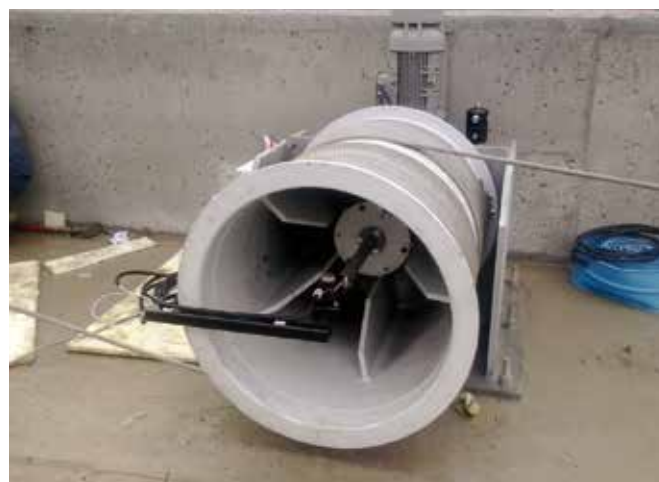
Figura 21 - particolare del sistema di movimentazione delle paratoie
