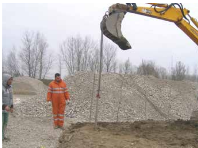
Figura 5: Realizzazione del foro per l'impianto delle pioppelle: fasi di inserimento e di estrazione del palo mediante escavatore.
